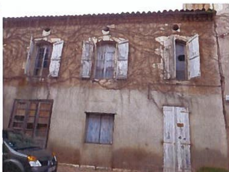
Vic-Fezensac –bien vacant présentant un caractère très dégradé
