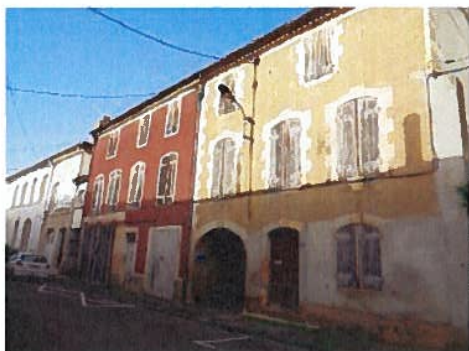
Vic-Fezensac -Ensemble immobilier vacant de grande taille dont la reconquête implique des travaux conséquents
